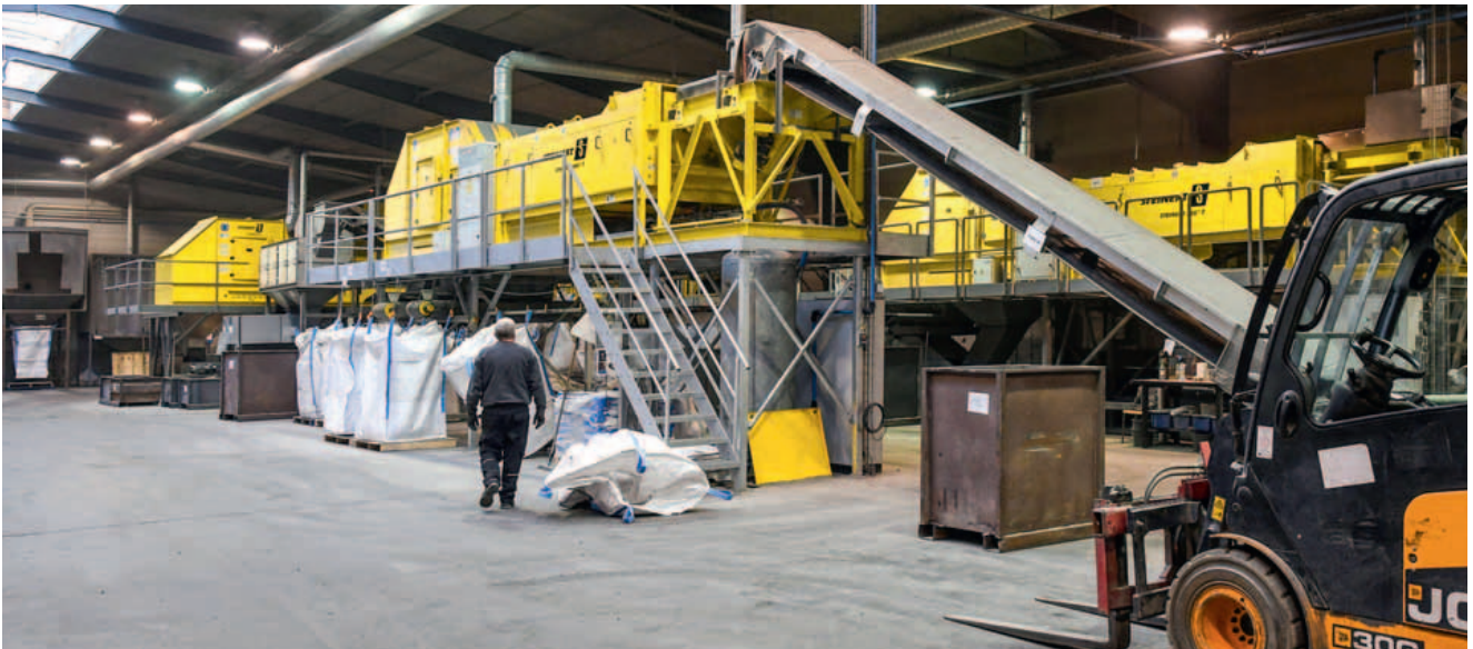
Bei Scanmetals erzeugen Steinert XSS T EVO 5.0 äußerst reines Aluminium. Schwermetalle werden aussortiert.
